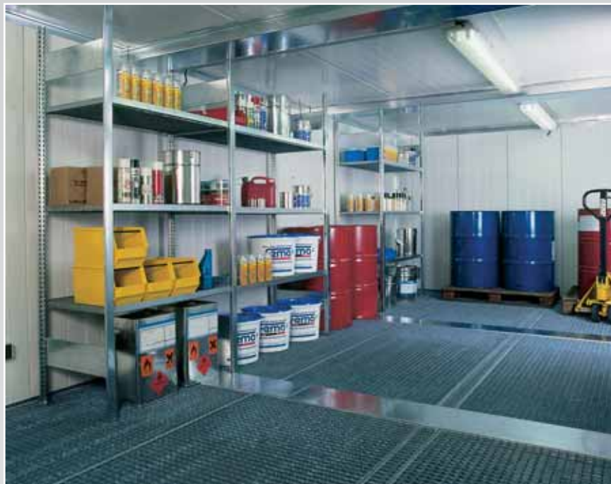
Innenansicht mit SC-Regal und Elektroinstallation
