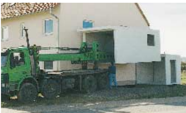
Garage mit hinterem Abstellraum Versetzen mit Spezialfahrzeugen oder je nach baulichen Gegebenheiten mit Kran
